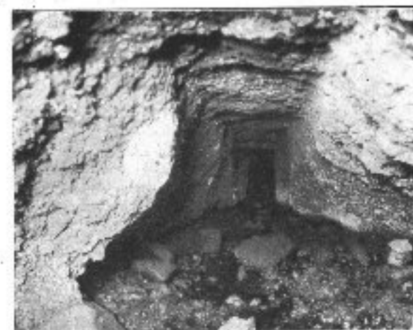
Fig. 12ª — Erosioni nella galleria
