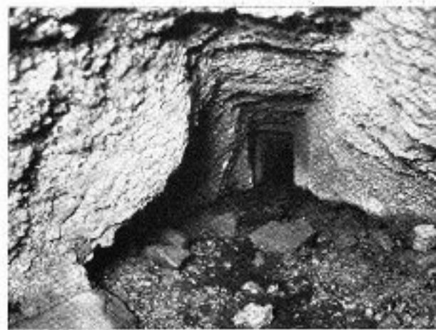
Fig. 13 - Erosioni della galleria principale
